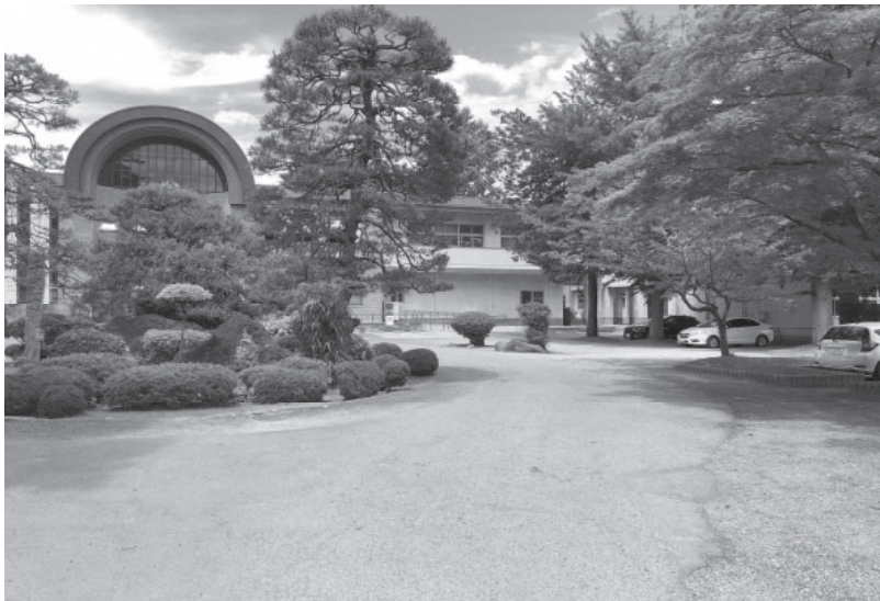
劣化・破損が進むアスファルト舗装
