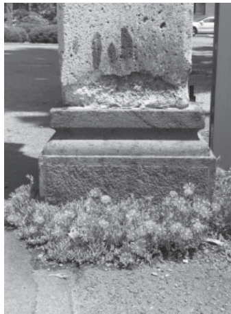
劣化が進んだ柱脚
