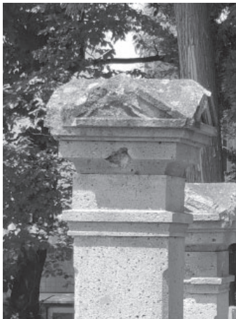
劣化が進んだ障笠 (芯ズレも発生している)
